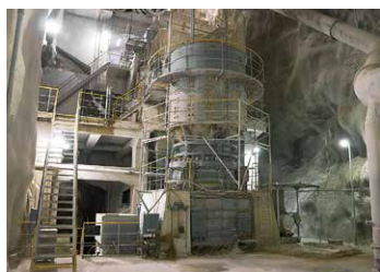
地下にある破碎設備(大平地区)
